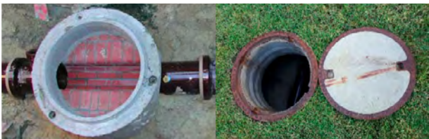
Abbildung: Beispiel einer Schachtsohle und Schachtdeckel Quelle: EVS
